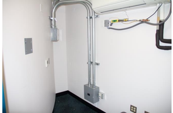
Image 2. Storage Closet for AV Rack.
